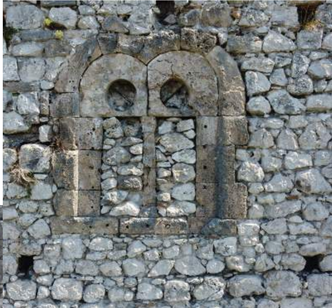
Fig. 12 Bifora moderna in stile "gotico". La colonnina centrale è stata sottratta e sostituita con cemento. "Gothic" style mullioned window. The pilaster has been stolen and replaced with concrete.
